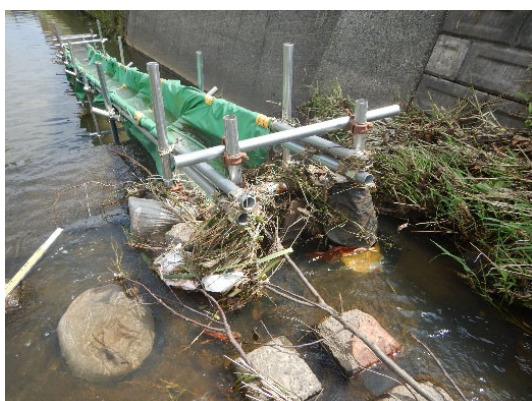
魚道最上流部のゴミ詰まり
