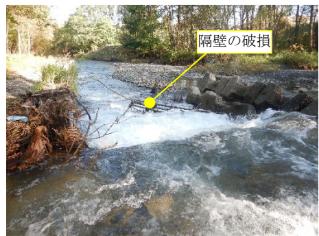
大規模出水による破損 (R1. 10. 18)
