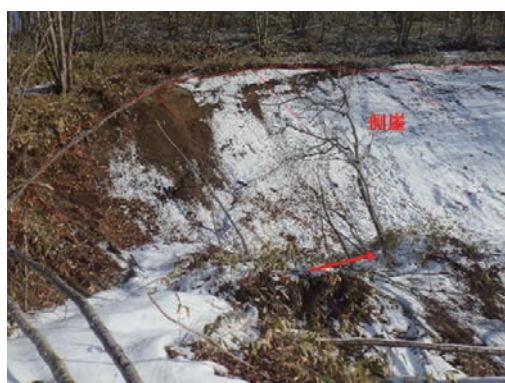
写真 3-11 地すべり④-2の地上写真 (頭部滑落崖から左岸側壁に連続する亀裂)
