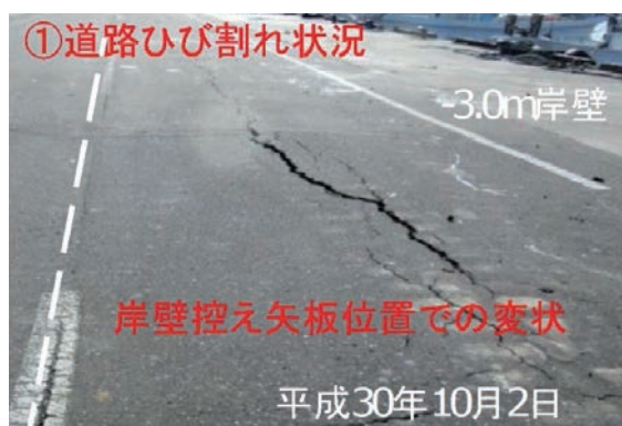
写真1 道路舗装の亀裂状況
