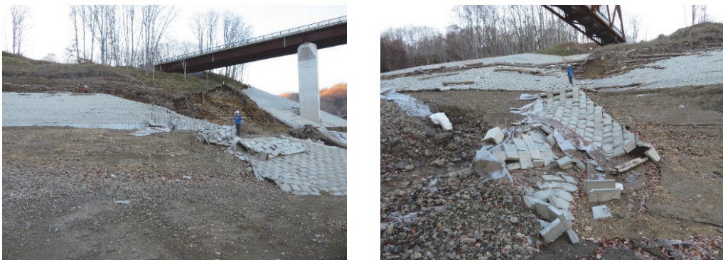
写真5 段波の遡上及び引き波により被災した地すべりL1-Aブロックの連節ブロック
