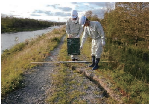
写真3 協会員による調査（堤防の亀裂箇所）
