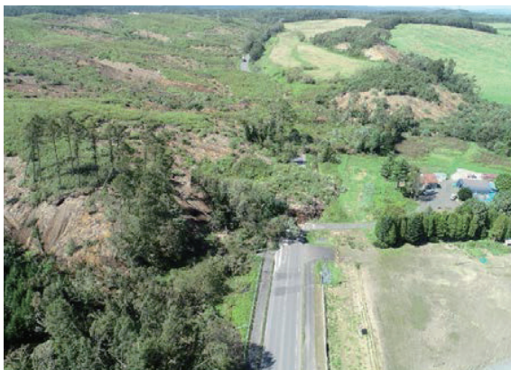
写真5 千歳鷗川線 厚真町本郷地区 9月6日撮影 被災確認
