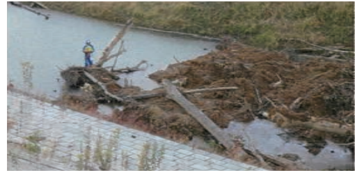
写真4 協会員による調査（河道の埋塞箇所）
