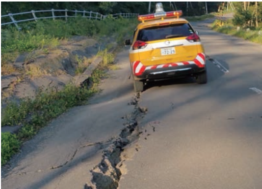
写真1 北進平取線 安平町早来北進地区 路肩決壊状況
