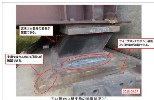
写真31 千歳鷗川線 厚真大橋 支承ゴムの変形状況等
