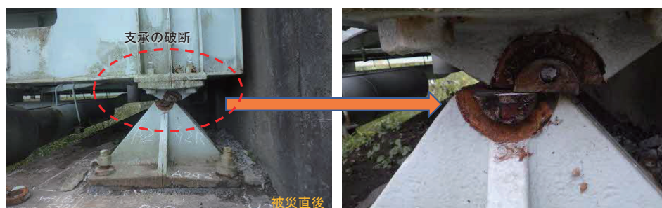
写真32 厚真浜厚真停車場線 上厚真大橋 支承破断状況
