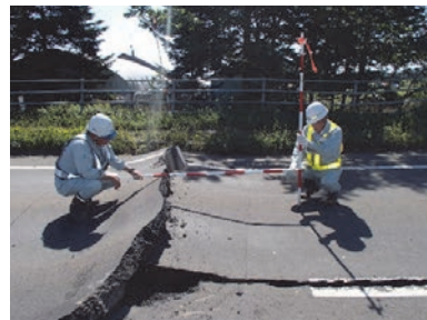
写真3 舗装隆起の調査状況 (千歳鷲川線北進橋付近)
