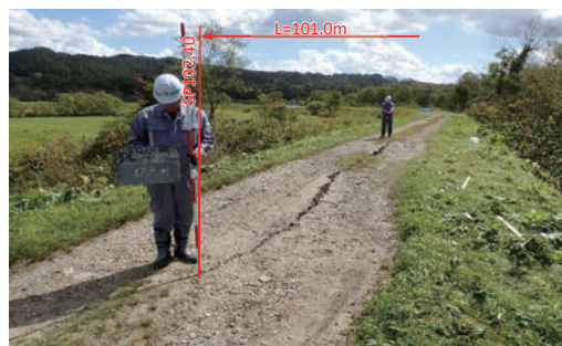
写真11 キナウス川堤防の縦断亀裂
