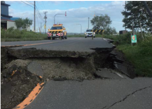
写真2 平取厚真線 厚真町宇隆地区 道路段差状況
