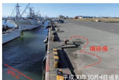
写真2 岸壁背面の噴砂状況
