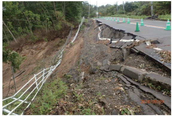
写真16 千歳鷗川線 厚真町ルーラル地区 大規模盛土崩壊
