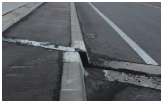
写真30 平取厚真線 厚真新橋 上部工変位状況
