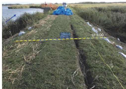
写真10 勇払川堤防の縦断亀裂
