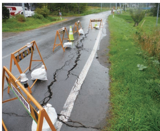
写真2 路肩クラック発生状況
