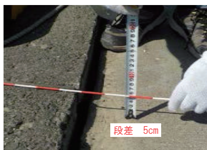
写真4 岸壁頭部の変位状況
