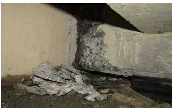
写真5 橋梁の点検状況（兄後橋：主桁の破損）
