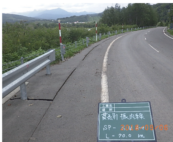
写真3 路肩クラック発生状況
