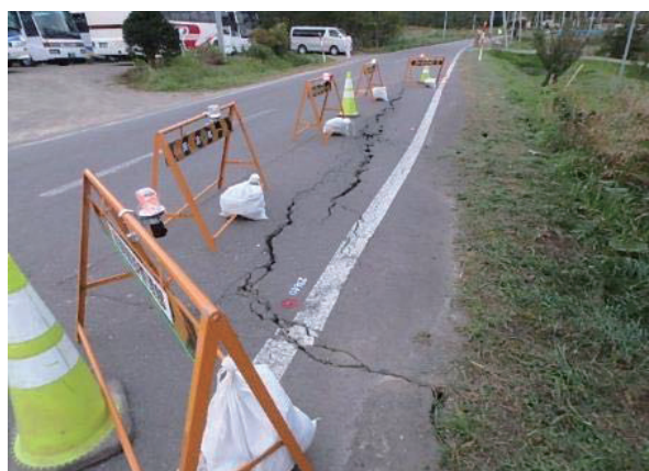
SP23640 亀裂状況
