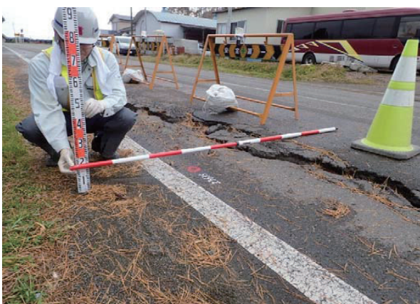
⑦沈下状況
