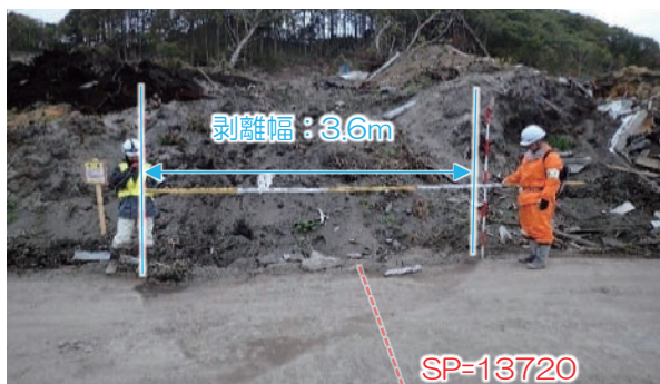
路面の剥離の状況
