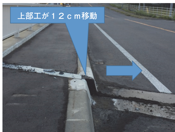
厚真新橋の被災状況
