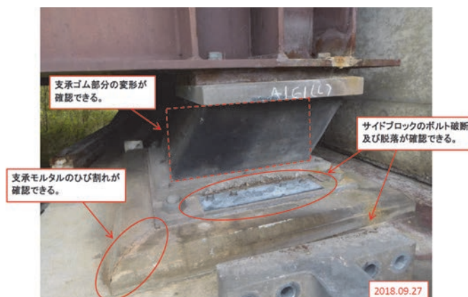
厚真大橋の被災状況
