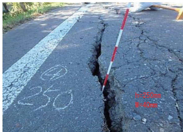
④亀裂状況
