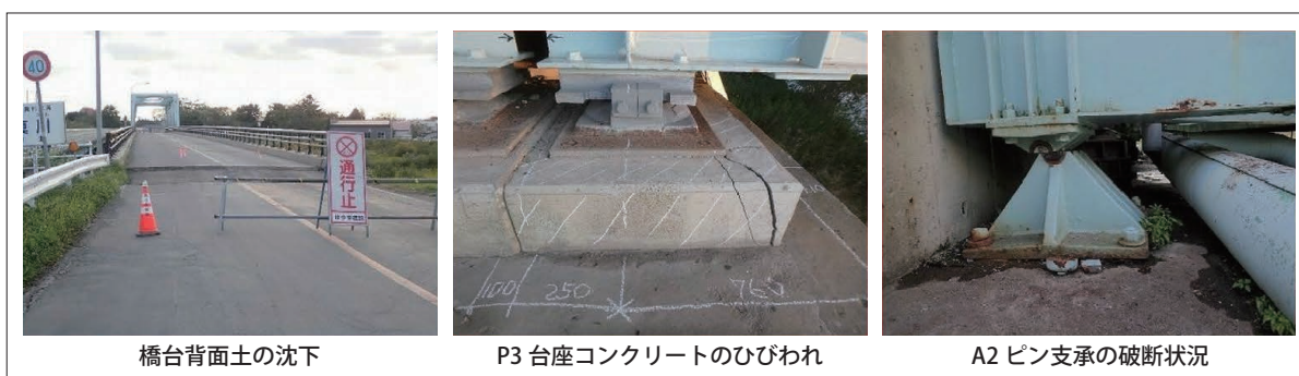
車道橋の被災状況
