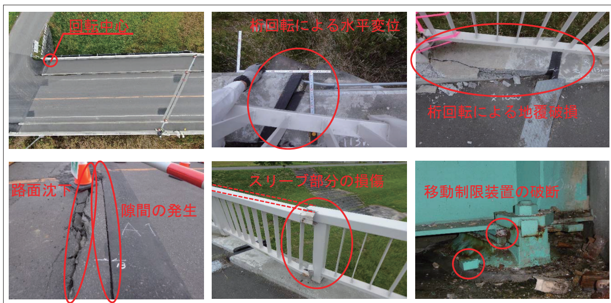
桁の回転移動による被災状況
