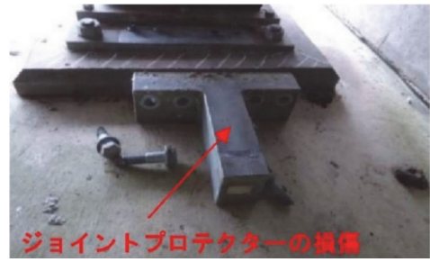
ジョイントプロテクターの転倒
