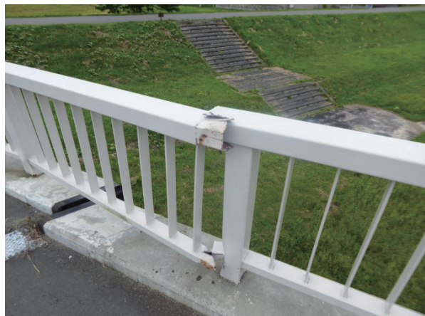
P1橋脚上流側防護柵・高欄破損
