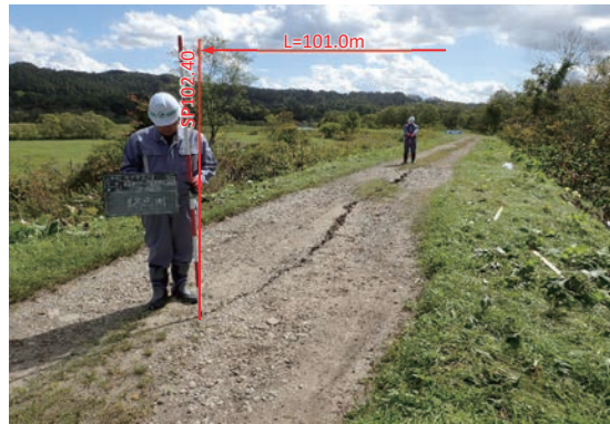
パターン②の写真（キナウス川：第256号）
