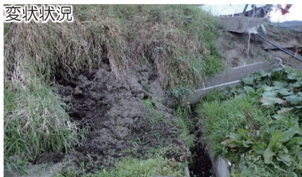
排水施設の変状
