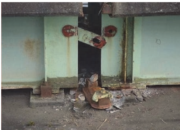
P3 落橋防止システムの破損
