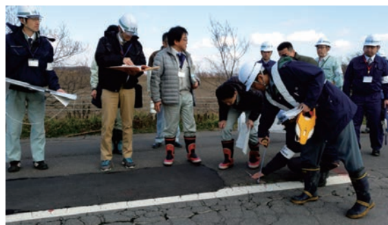
写真2 舗装クラック、起終点確認（第15次査定）
