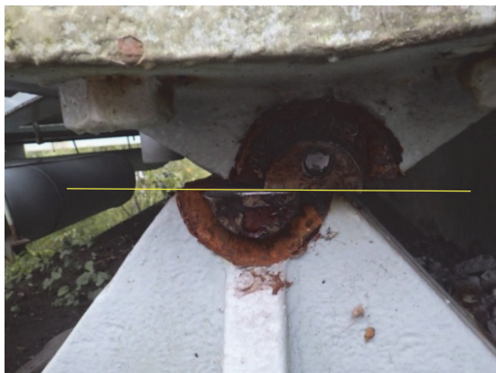
支承のせん断破損
