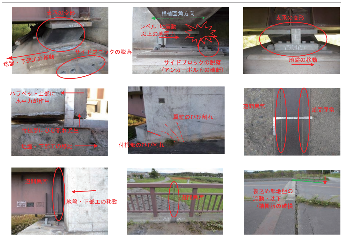
地盤の移動による被災状況
