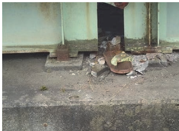
P3 線支承の破損
