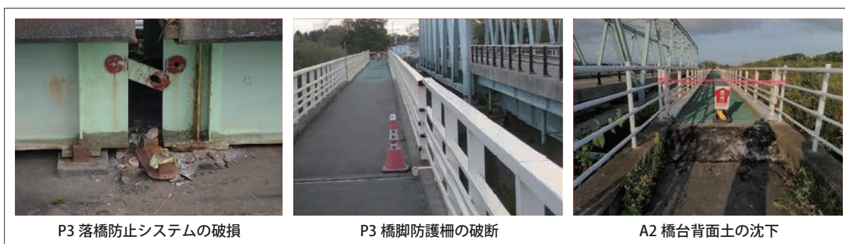
歩道橋の被災状況
