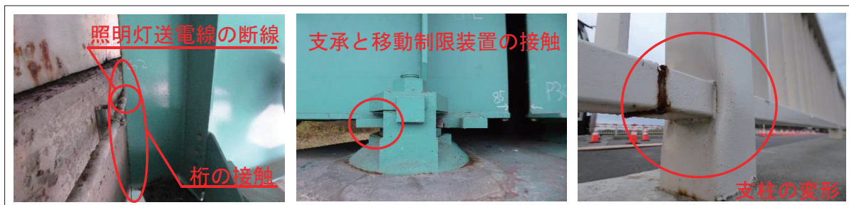
桁の移動による被災状況
