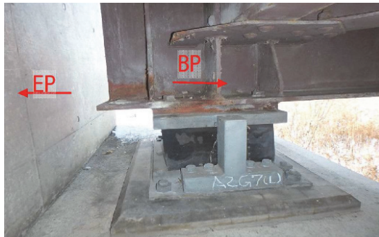
A2G7 主桁端部 (遊間あり) 過年度点検 (H27) 遊間異常 (主桁端切断)
