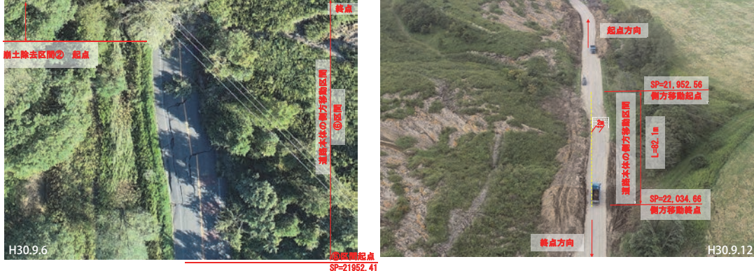
SP21952 ～ SP22034 付近全景（道路本体の側方移動区間）
