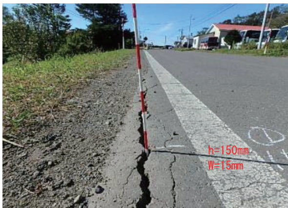
①亀裂状況
