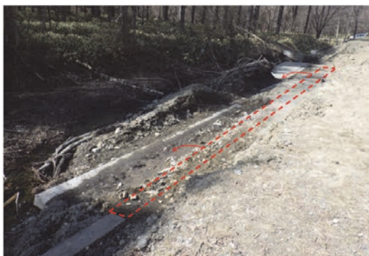
崩土除去に伴い被災が確認された道路擁壁
