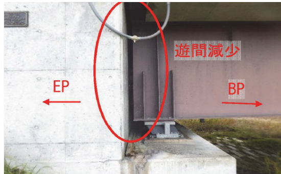
A2L 側主桁側面 (遊間減少) 被災後
